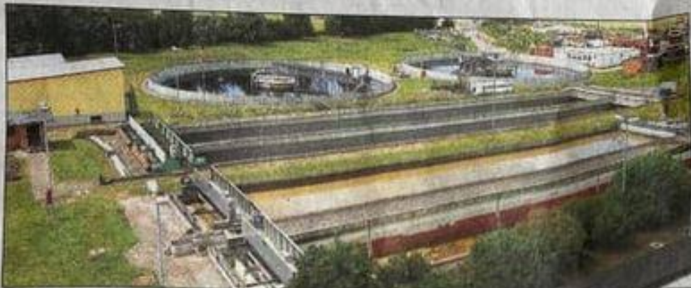
Im Vordergrund sind die beiden Vorklärbecken zu sehen, im Hintergrund die beiden runden Nachklärbecken der biologischen Reinigungsstufe; oben rechts ein Teil der Baustelle, auf der die vierte Reinigungsstufe entsteht. Fotos: Alex
