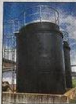
In diesen beiden Silos werden die Chemikalien zur Fällung gelagert.
